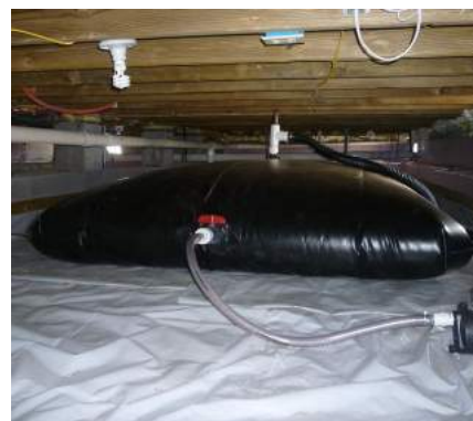
Ondergrondse waterberging onder woningen
