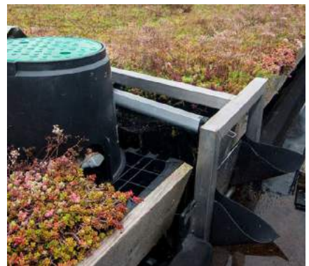
Polderdak met automatisch regelsysteem
